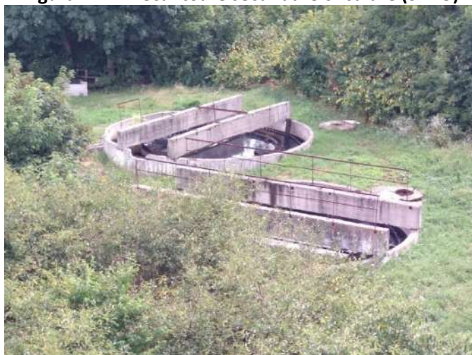
Figura 4-12: Decantoare secundare circulare (SEAU)
