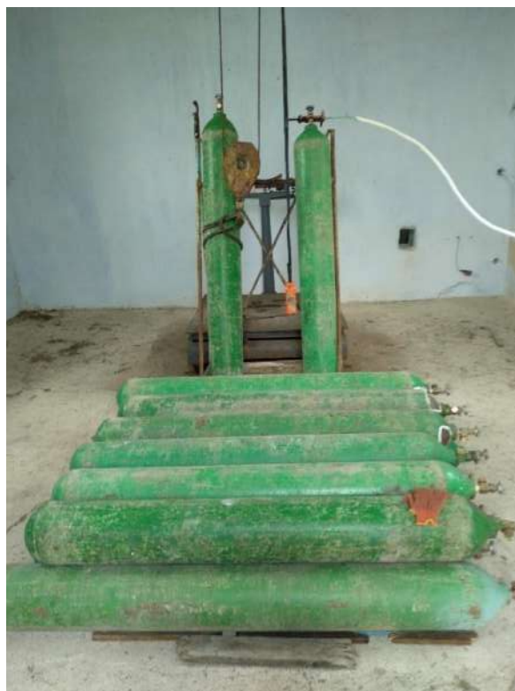
Figura 3-16: Stația de clor – depozit (SP-04)
