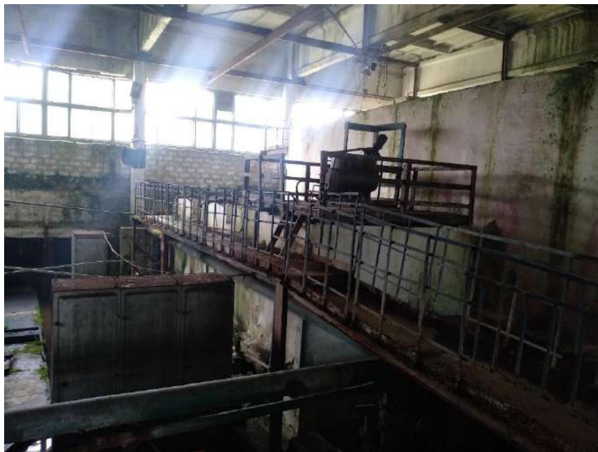
Figura 3-7: Gospodăria de reactivi (STA)
