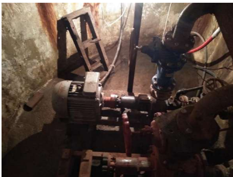
Figura 4-4: Agregatele de pompare SPAU-3
