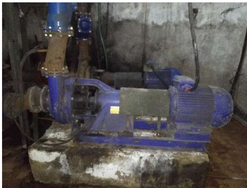
Figura 4-2: Agregatele de pompare SPAU-2
