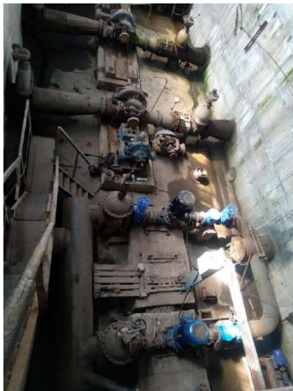
Figura 3-3: Interiorul stația de captare (SP-01)
