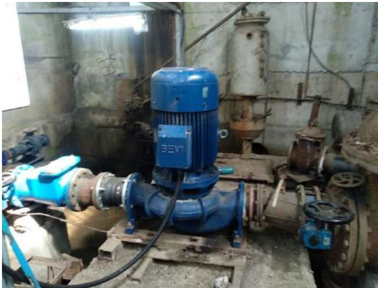
Figura 3-2: Stația de captare SP-01 (pompa ABS VM-208/4A)
