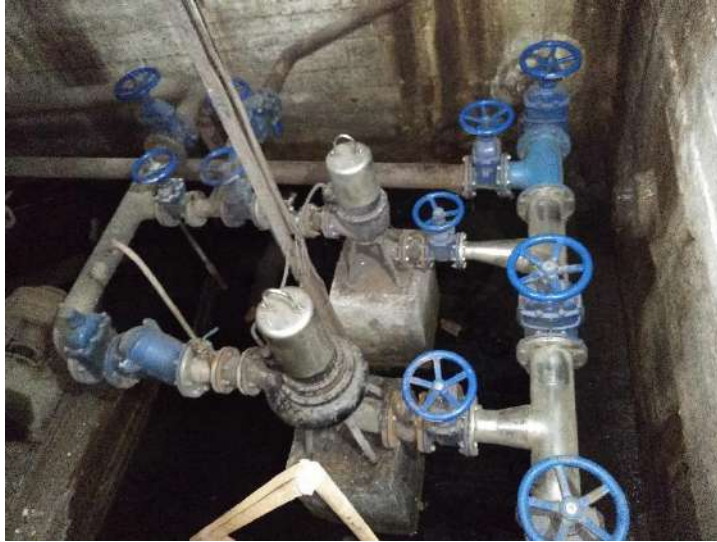
Figura 4-13: Stația de pompare a nămolurilor (SEAU)
